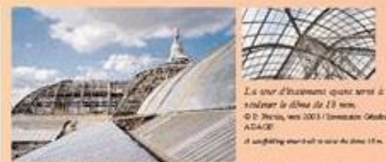
La pose d'insaisonnables optiques permet de sceller le dôme de 18 mm. © D. Steiner, juin 2003 / Innovation Global / ADAGE A sunlight shield will be used to seal the dome 18 mm. © B&O.C / I'E' International Merrine de la nef sud des nouveaux vitres du Grand Palais. La charpente a été peinte couleur d'orange. L'ancien verre orné a été remplacé par un verre feuilleté, juillet 2003. © B&O.C / I'E' International Southern nave of the new glass roof of the Grand Palais. The framework has been painted orange. The old glass has replaced by a laminated glass.
