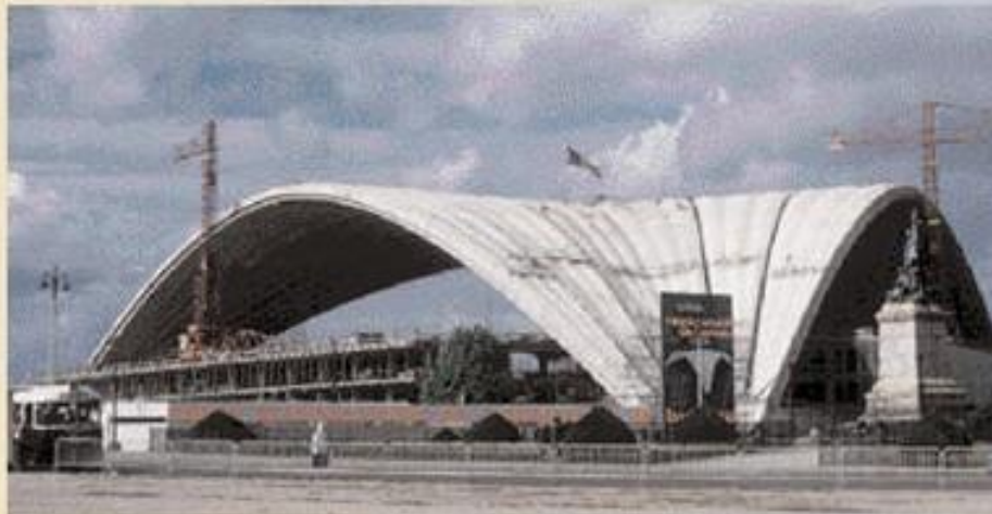
L'échafaudage est totalement démonté pour l'ouverture, le 10 septembre 1955, du Salon de l'Équipement de Bureau. Le soleil apparaît dans toute son étendue.
